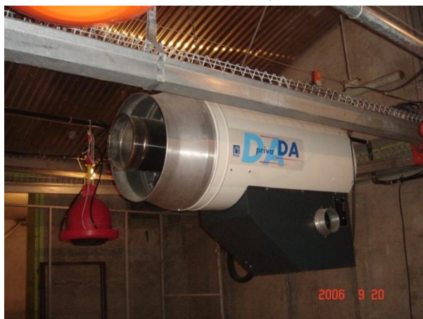
سیستم فن جت برای گرم کردن سالن
